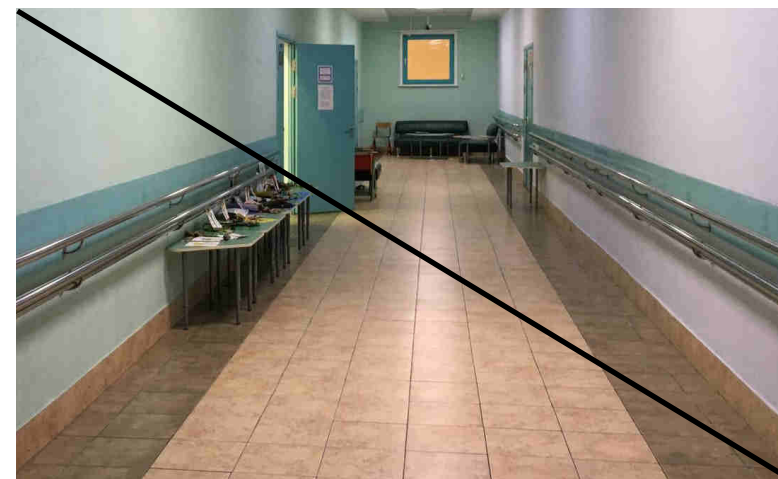
Плохо Керамогранитная плитка с крупными швами
